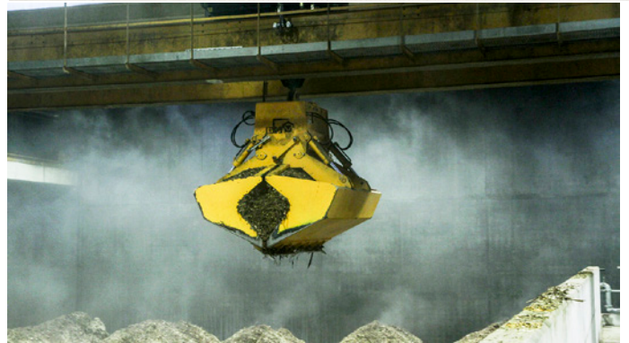
BioWarmteCentrale van Stadsverwarming Purmerend. Bron foto's: RTV Purmerend.
